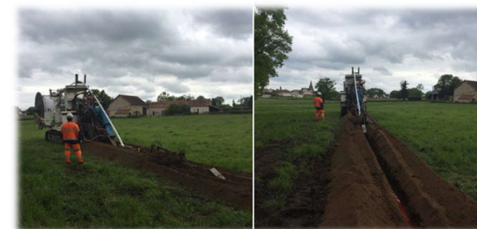
Figure 1 Exemple de chantier d'enfouissement d'un réseau électrique en terres agricoles (source : Cegelec infra)
